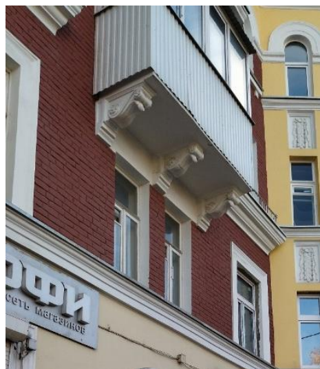
Рисунок 24 – Кронштейн (фото здания по ул. Победы)
