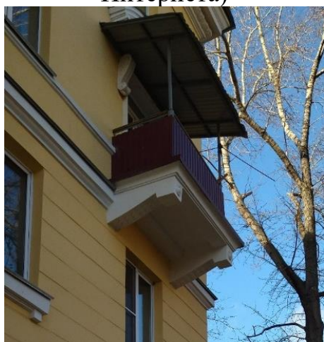
Рисунок 25 – Кронштейн (фото здания по ул. Калинина)
